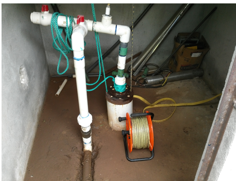
Foto 1. Pozo 1 (Coordenadas 392729 E / 222764 N).
