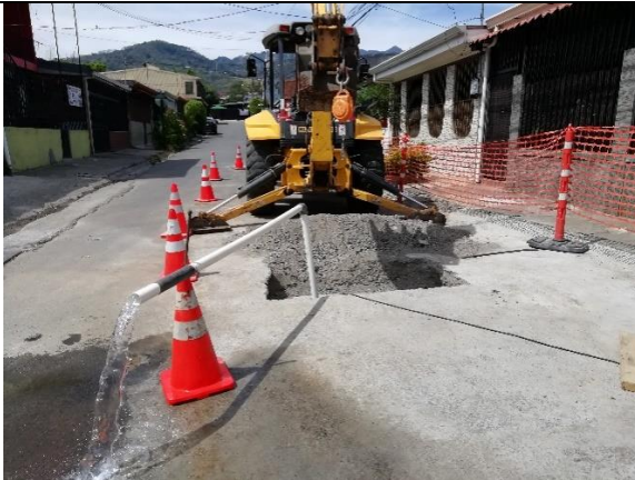
Fotografía 1: Pozo sanitario 25-60A, coordenadas: 209472 N/526031E
