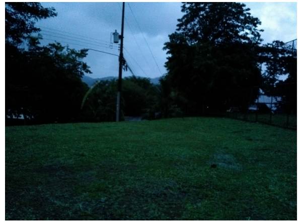
Se observa el otro poste en referencia, el cual está frente a terreno (carretera 162)
