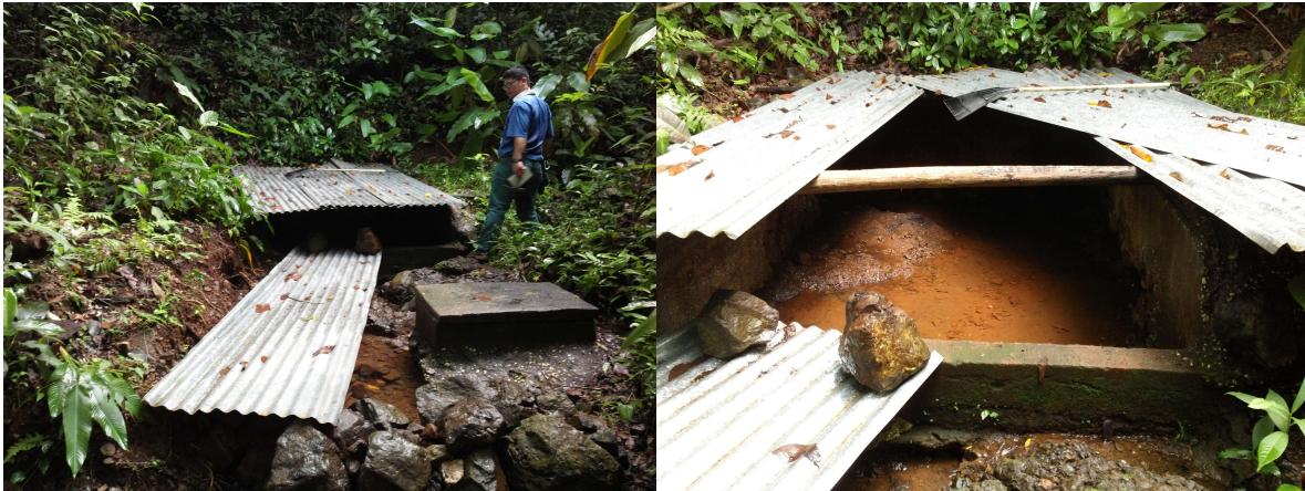
Fotos 7 y 8: Captación principal
