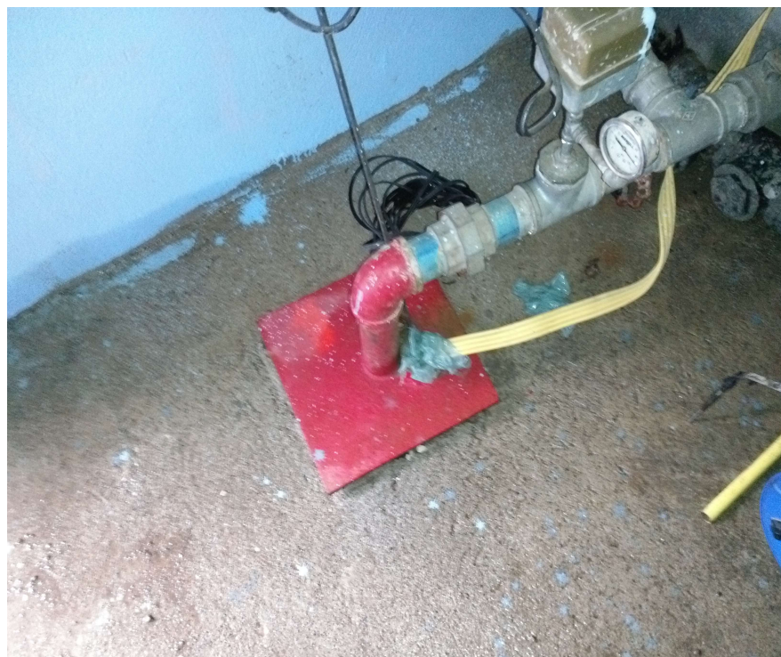
Foto 1. Pozo 1. Coordenadas: 370714 E/207337 N
