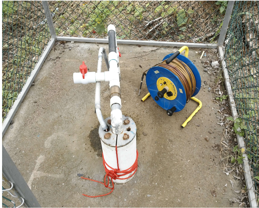
Foto 2. Pozo 2. Coordenadas: 370703 E/207383 N
