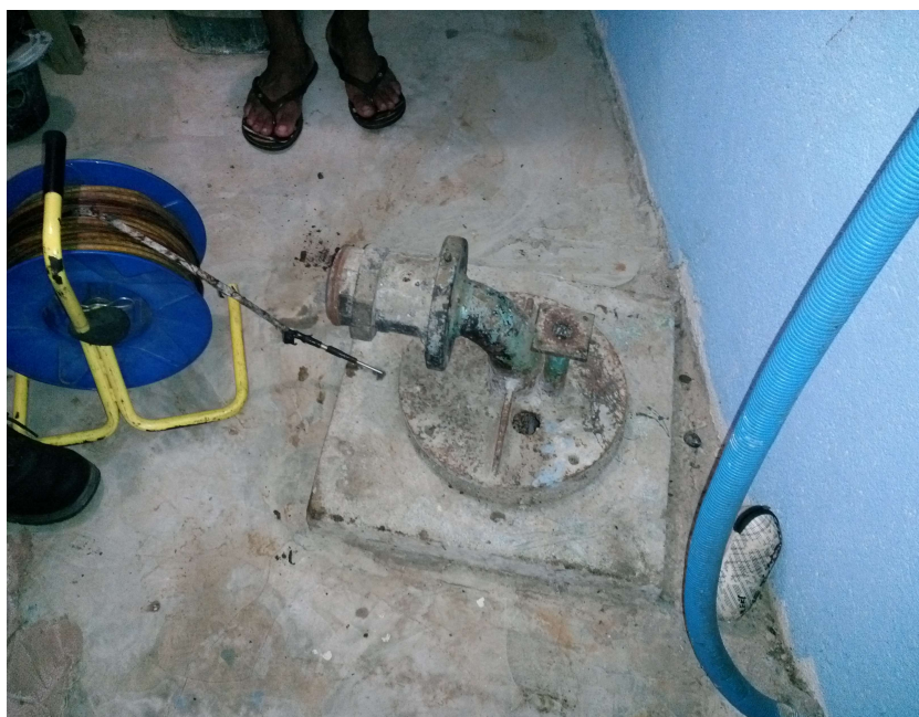
Foto 3. Pozo 3. Coordenadas: 370733 E/207324 N
