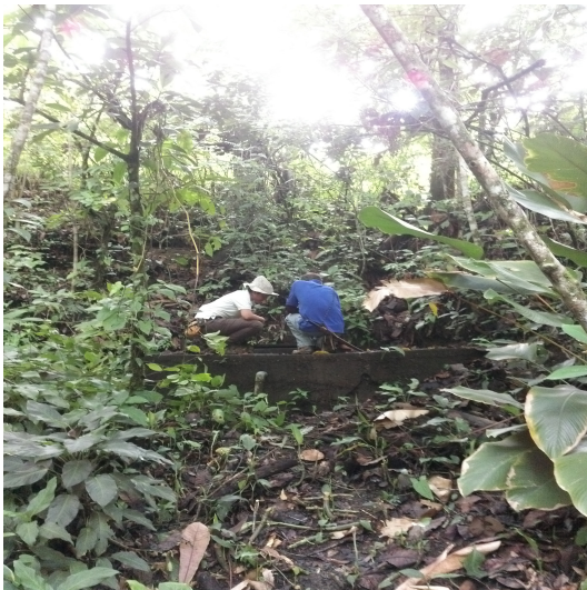
Captación de naciente 2a. Coordenadas 397446 E / 217224 N
