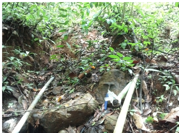
Captación de naciente (solo se observó la tubería, no se logró observar caja, ya que fue tapada por deslizamiento). Coordenadas 396075 E / 215484 N
