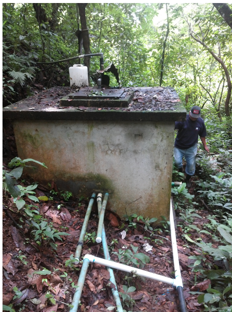
Figura 5. Tanque de almacenamiento y distribución. Coordenadas 396072 E / 215491 N
