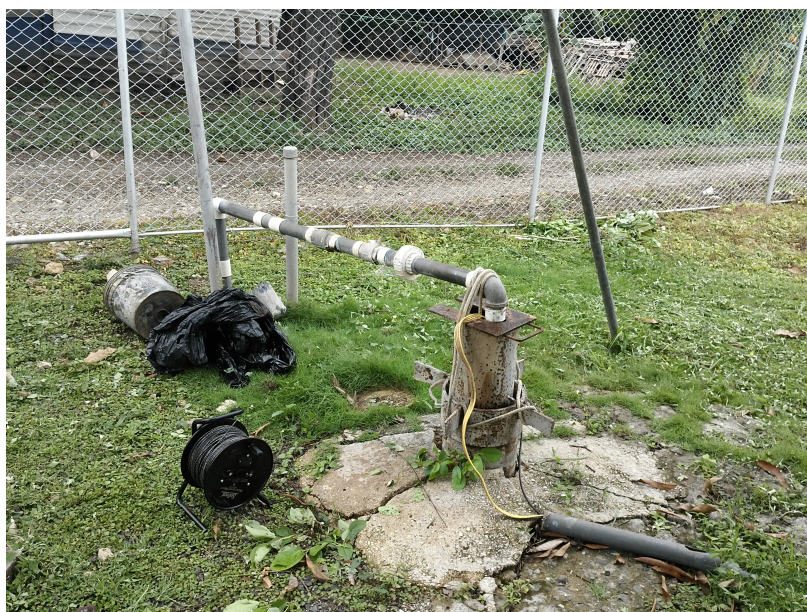
Foto 1. Pozo 1 (Coordenadas 401450 E / 243947 N).
