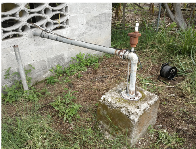
Foto 2. Pozo 2 (Coordenadas 402907 E / 245939 N)
